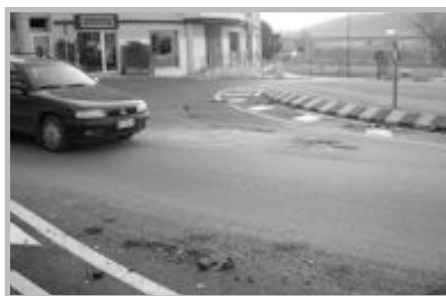
COME VIALE PARCO La rotatoria di via Panebianco: crollata appena dopo l'inaugurazione
